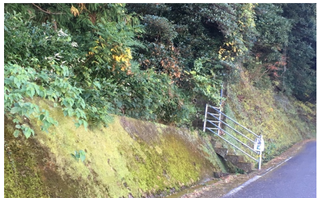
図3. 法面のコンクリート壁に生育するコケ類。
