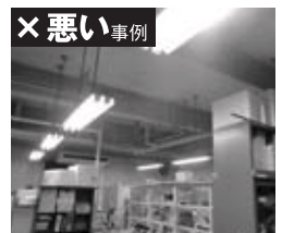
× 悪い事例 基礎・臨床研究棟 実験室 誰もいないのに、照明と空調機が点けっ放しです。
