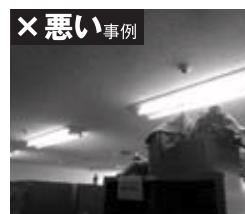
× 悪い事例 中央診療棟 更衣室 外光利用により室内灯を間引き消灯され、節電意識はあるようですが、点けっ放しで誰も居ませんでした。最後に部屋を出られる人は消灯を忘れずに。
