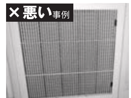
× 悪い事例 大学院研究棟 研究室 空調室内機のフィルターの目詰まりが見られました。
