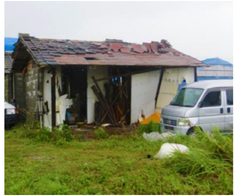
2014年台風8号 高知平野で発生した竜巻の被害
