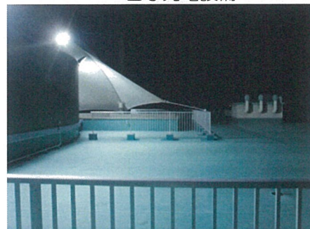
夜間照明設備
