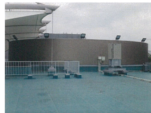
LED夜間照明 (ソーラータイマー制御)
