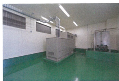
自家発電装置
