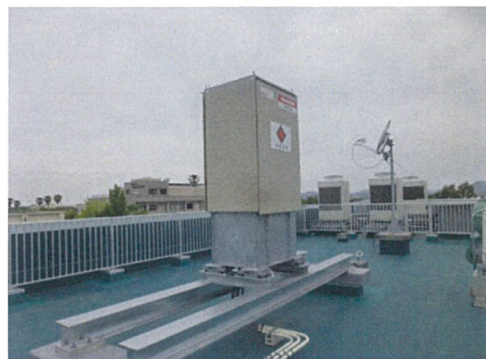
自家発電設備
