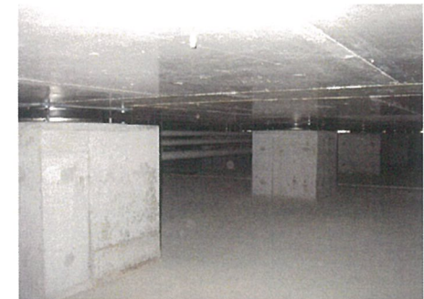
床下免震装置
