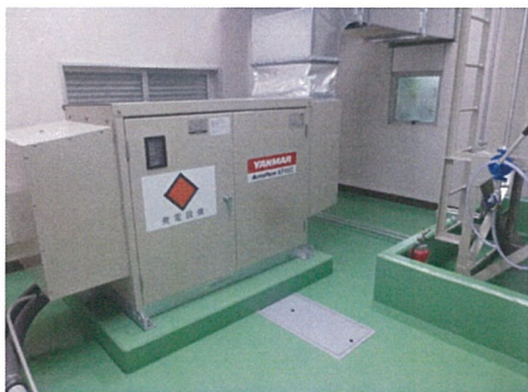
自家発電設備
