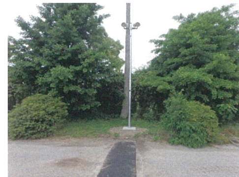
非常放送設備
