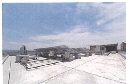
屋上太陽光パネル
