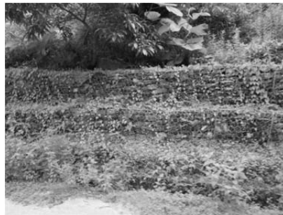
写真-1 蛇籠擁壁への植生繁茂の状況（ネパール国）
