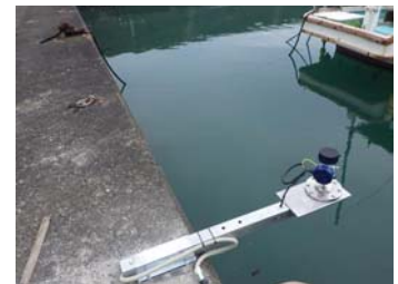
漁港に設置した水位計
