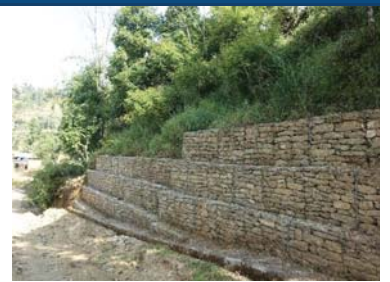
日ネ技術者の共同施工によりネパール国内に完成した「改良型防災蛇籠擁壁」
