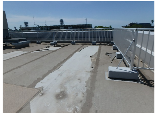
屋上防水シートの劣化
