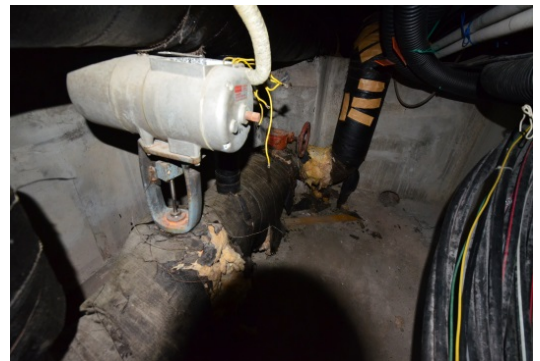
岡豊団地共同溝内現状
