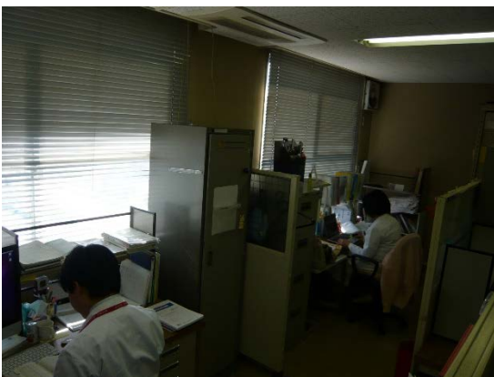
老朽化状況（照度不足）
