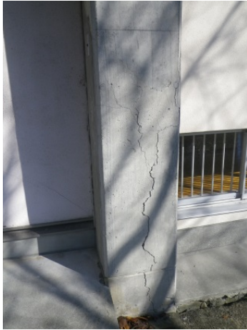
鉄筋コンクリート柱のひび割れ
