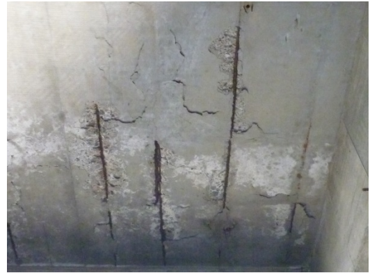
鉄筋コンクリート床下の鉄筋腐食
