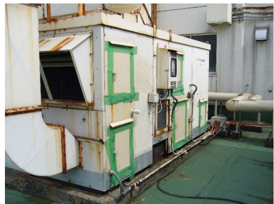
老朽化状況（空調室外機）
